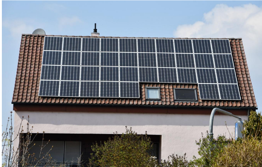
PV-Anlage auf dem Dach
