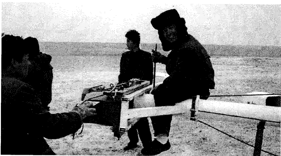
Abb. 4: Am Rande der Gobi-Wüste. Chinesische Techniker installieren den Maschinensatz des Windrades Inventus 6 von WENUS
