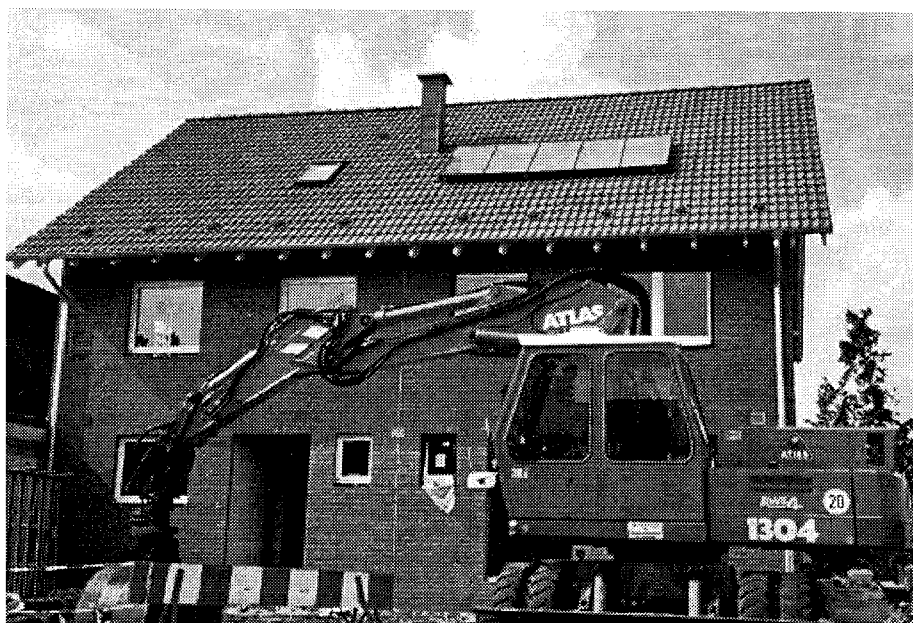
Abb. 1: Das Öko-Niedrigenergiehaus mit seiner Kollektoranlage
