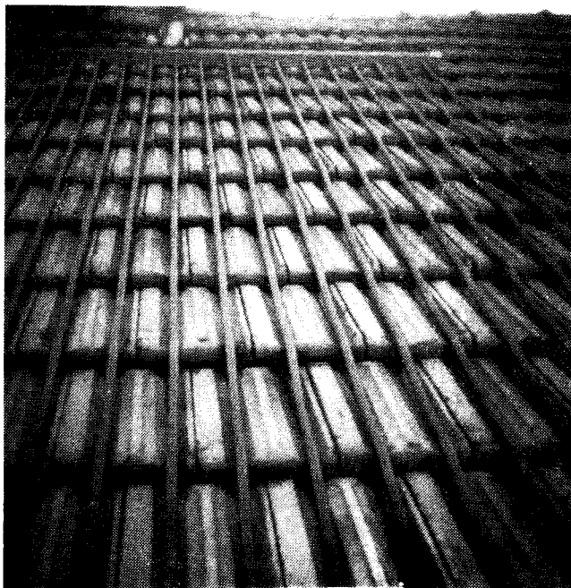
Bild 1: Die schwarzen PVC-Weichschläuche auf dem Ziegeldach sind unauffällig, billig und außerdem problemlos zu montieren, da sie leicht sind und durch Witterungseinflüsse keinen Schaden nehmen
