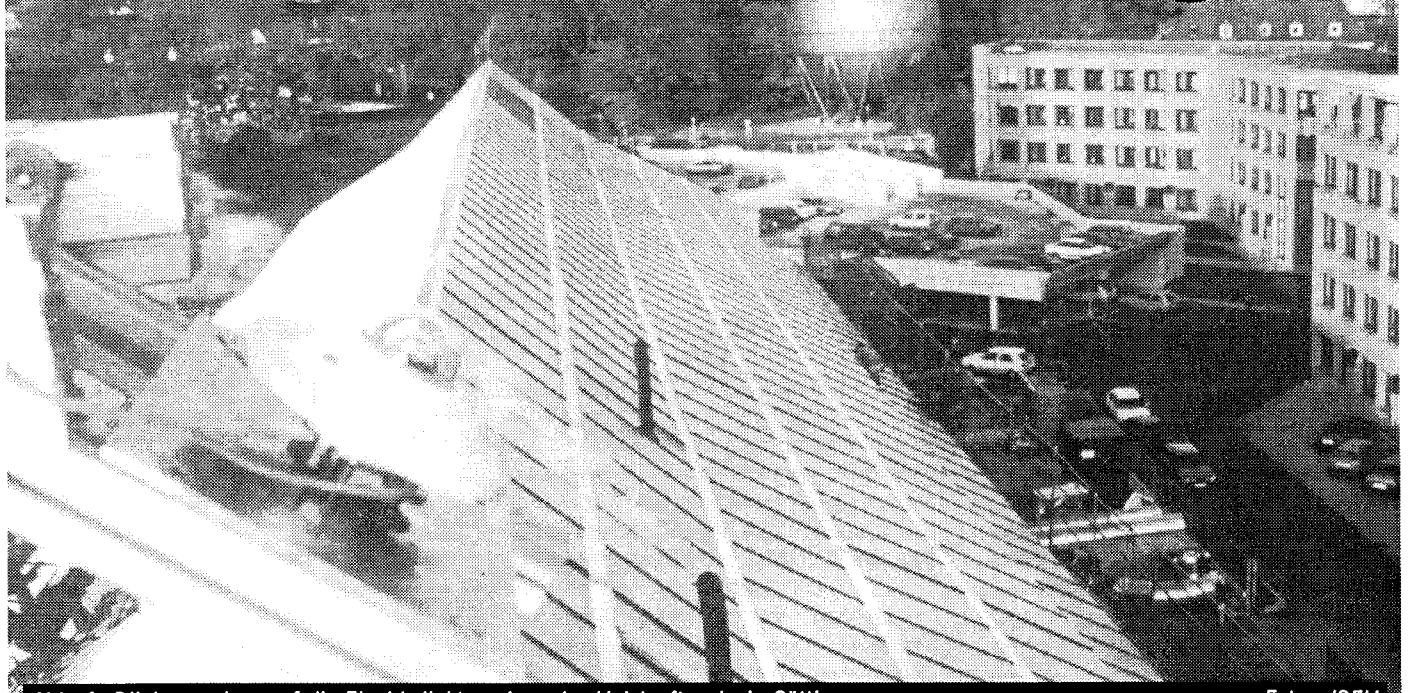
Abb. 1: Blick von oben auf die Flachkollektoranlage des Heizkraftwerks in Göttingen
