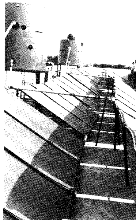
Zusammengeschaltete Thermosyphonanlagen, die auf dem Dach eines Hotels in Madras zwei 2000-l-Speicher speisen.
