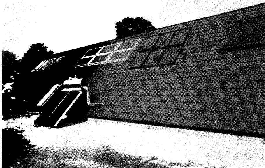
Freilicht-Prüfstand für solare Heizungsanlagen des TÜV Bayern in Großhadern bei München
