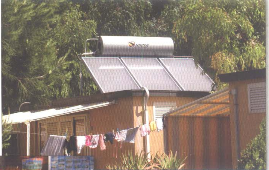
Solcamp-Award II: Thermosiphonsysteme sind in weiten Teilen Italiens für die Warmwasserbereitung gut geeignet. Fotos (2): Solcamp
