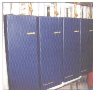
Viele Anbieter bevorzugen Frischwasserstationen, um der Legionellengefahr zu begegnen. Für größere Leistungen werden mehrere Stationen als Kaskade geschaltet.
