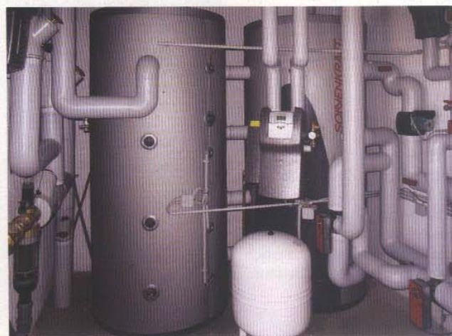
Die Warmwasserbereitung auf dem Campingplatz erfolgt durch ein Frischwassermodul FWM35 von Sonnenkraft.
