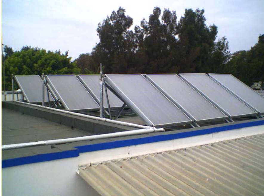
Fig. 21 Colectores colocados num telhado plano, Parque de Campismo da Fuseta
