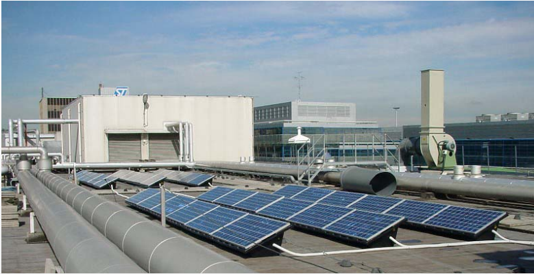
3,6 kW PV Phowatt
