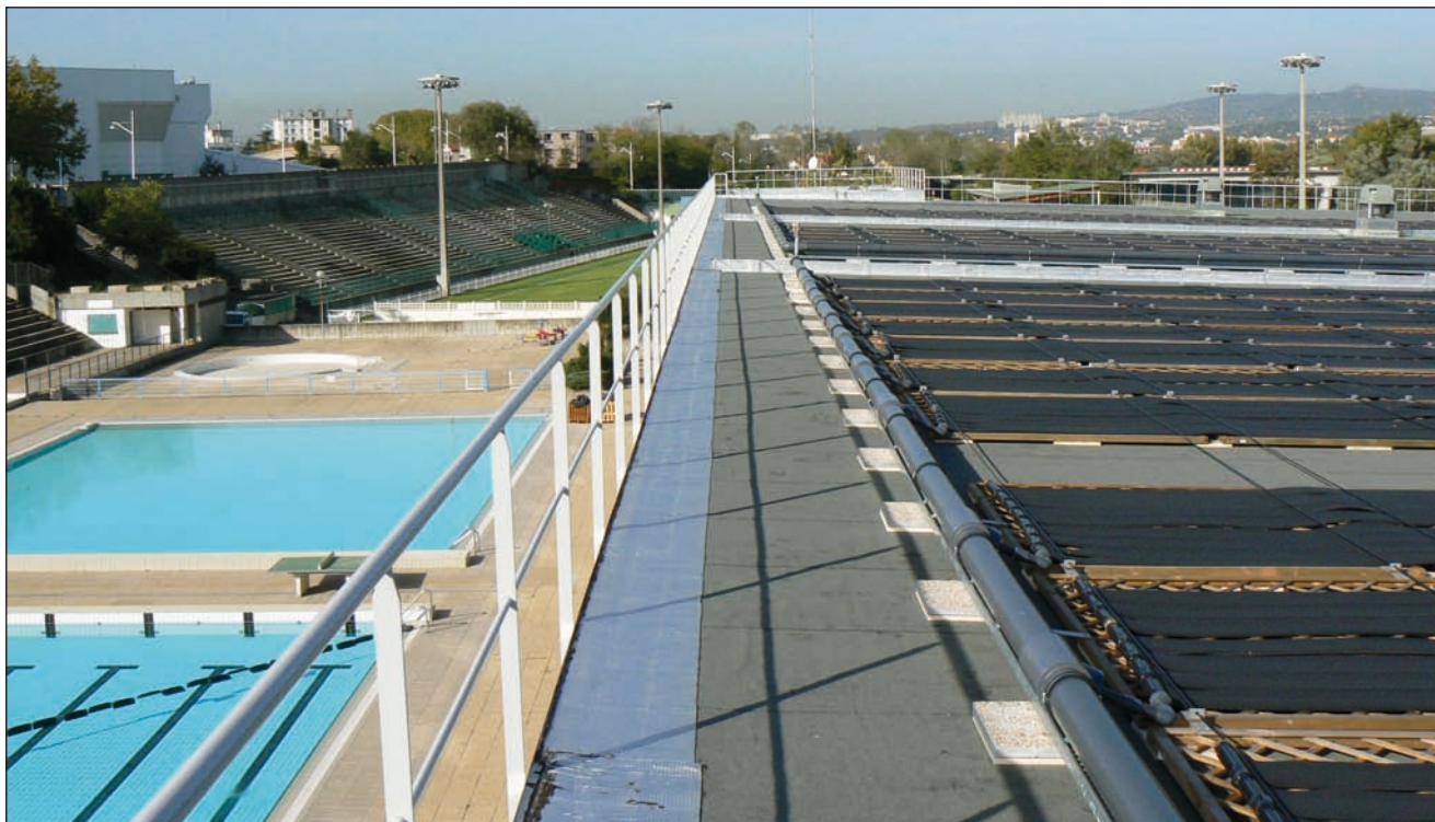
Bild 1: Freibad mit Absorberheizsystem in Villeurbanne, Frankreich
