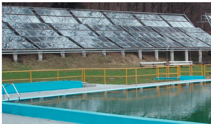
Západní sekce kolektorového pole na koupališti Rusava
