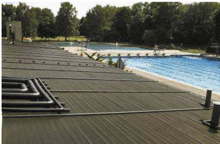
Fig 16 Sistema solare per il riscaldamento dell'acqua di una piscina estiva all'aperto a Mariendorf, Berlino (foto DGS)
