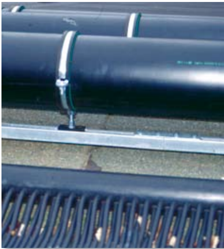
Abb. 16 Beispiel gleitender Verlegung der Rohre mit Schellenanker (Foto: DGS)
