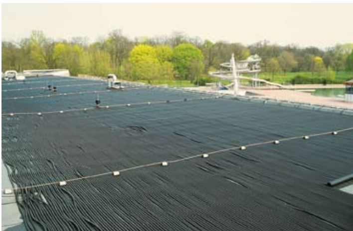
Abb. 17 Solaranlage zur Freibadbeheizung im Sommerbad Pankow, Berlin (Foto: DGS)
