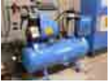
Kompressor zur Erzeugung der Luft für die pneumatischen Klappen
