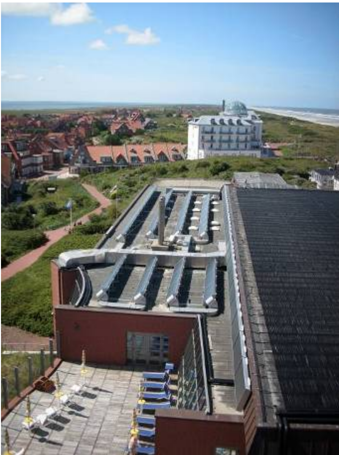
Figure 7: Combinaison de capteurs à air et de capteurs non vitrés
