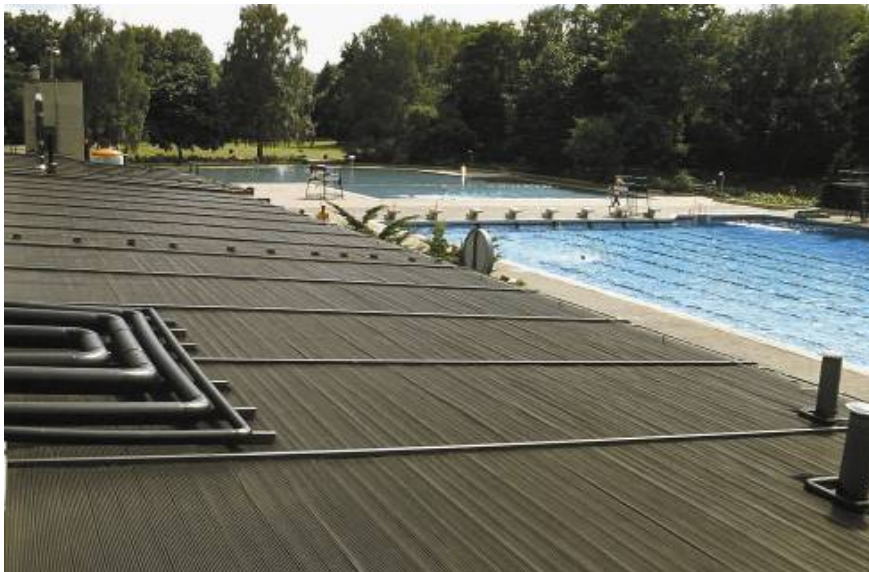
Abbildung 6: Kunststoffabsorberfeld direkt am Beckenrand
