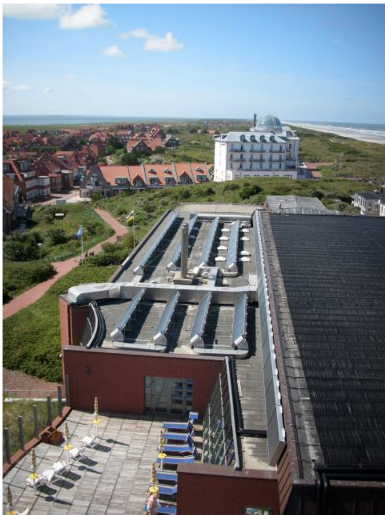
Abbildung 10: Kombination von Luftkollektoren und Kunststoffabsorbern (DGS, 2008)
