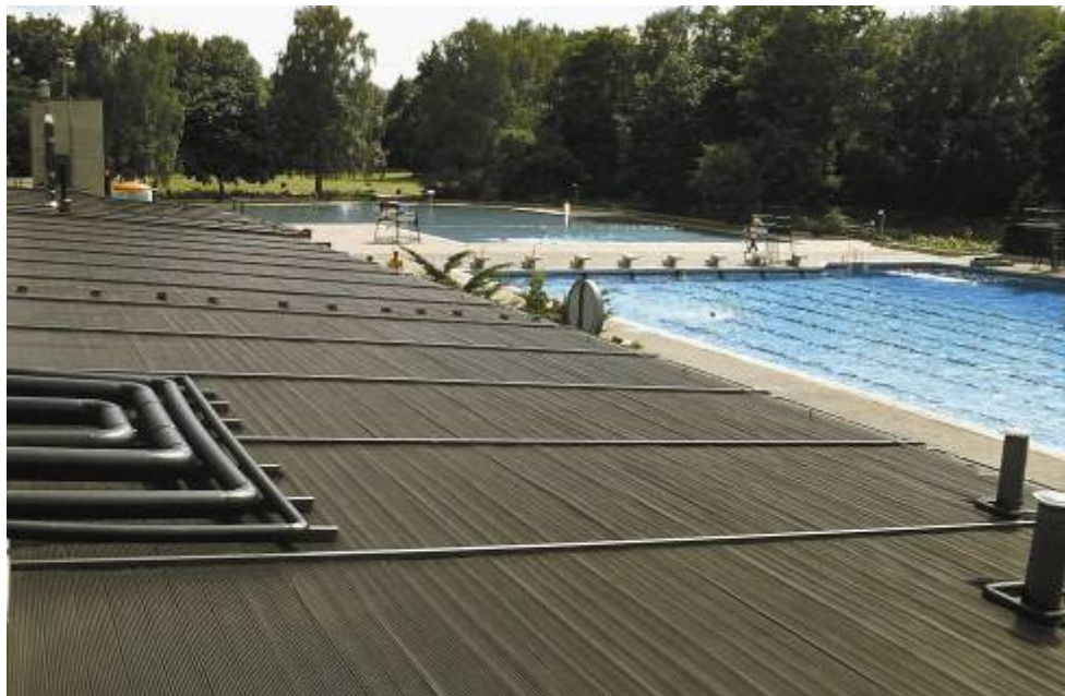
Abbildung 4: Kunststoffabsorberfeld direkt am Beckenrand
